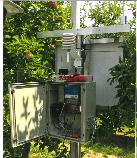
Foto 5: Klimamonitoring in der Anlage.
